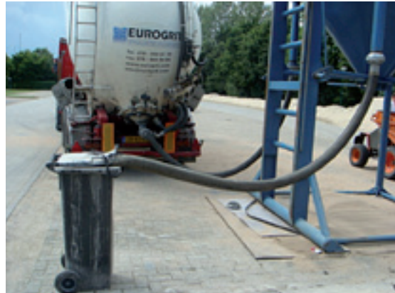
waterbak luchtuitlaat silo
